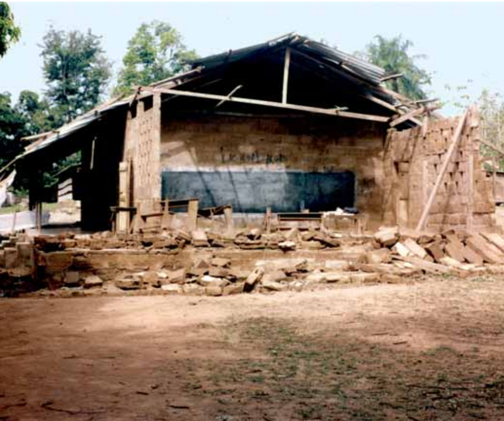
In dem von einem Sturm zerstörten Gebäude kann kein Unterricht mehr gehalten werden.
